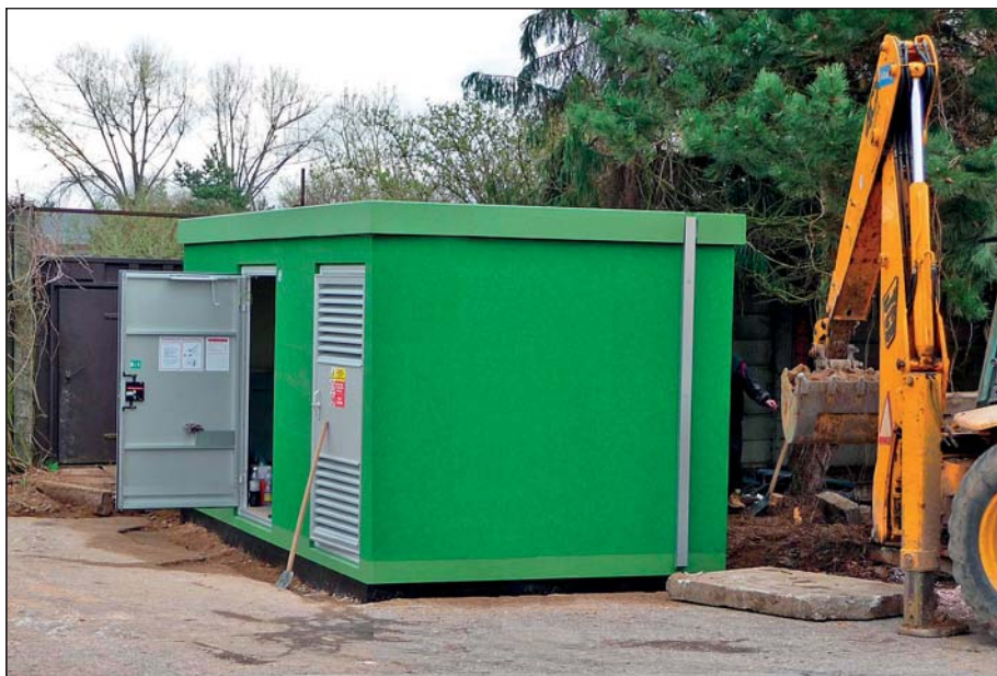
Nová přemístěná trafostanice. (vm)
